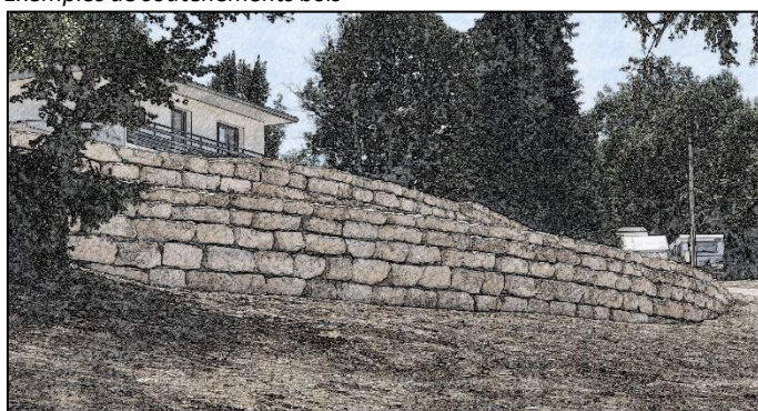
Exemples de soutènements non autorisés
