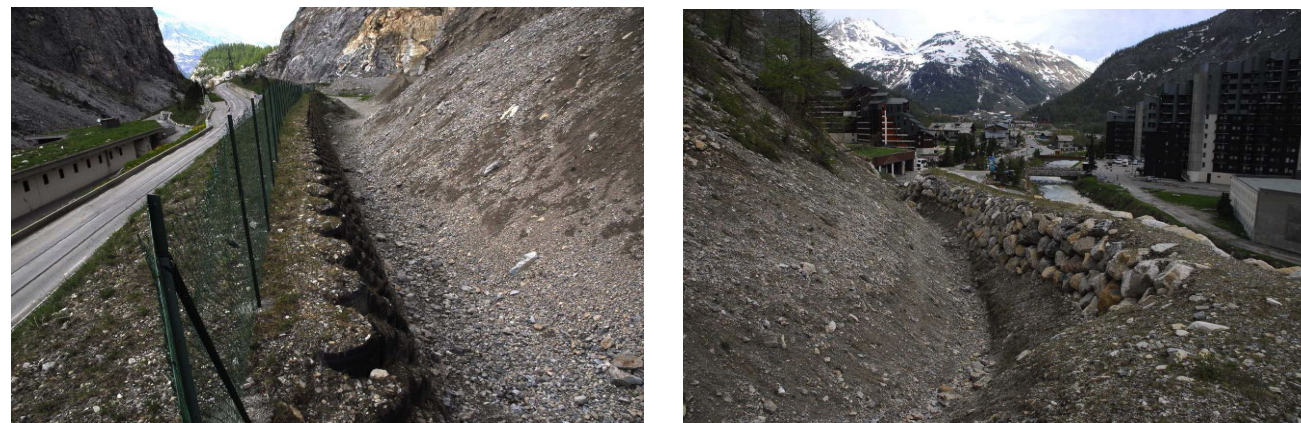
Fig. 5 et 6 : à gauche, le merlon en pneus au droit du centre technique municipal ; à droite la prolongation du merlon en enrochements jusqu'aux garages STVI (photos RTM73).
