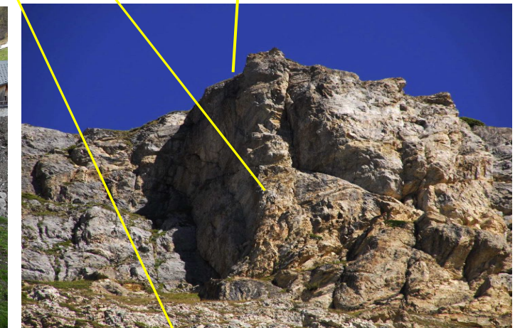
Fig. 4 et 5 : vues rapprochées des principales instabilités dans la barre de dolomies (photos RTM73)
