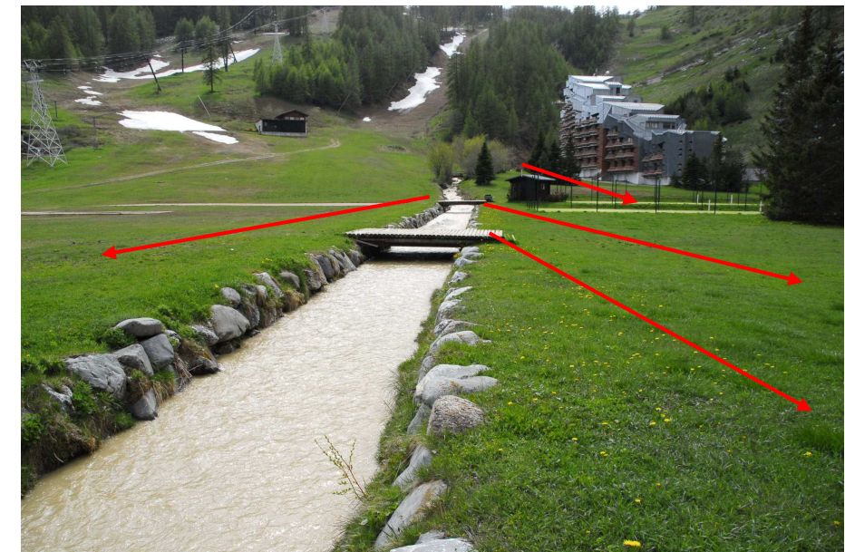
Fig. 3 : ruisseau de la Tovière dans la plaine de La Daille. Au fond le « Santel ». Noter les risques de débordements sur les 2 rives (photo RTM73).
