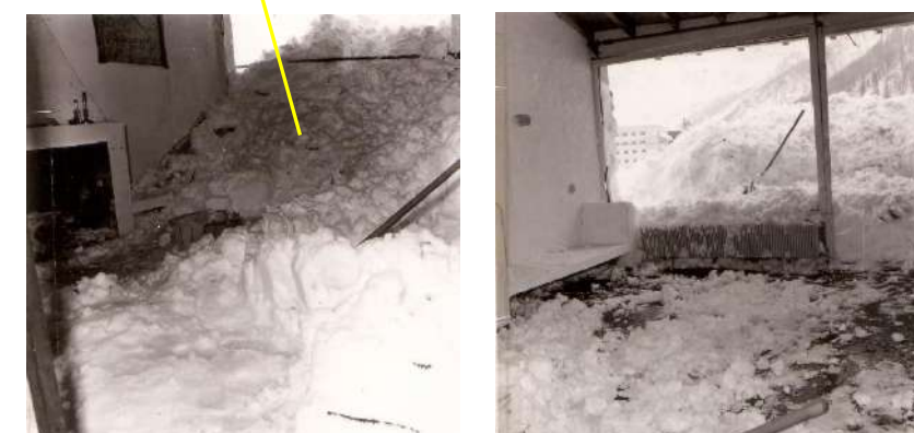
Fig. 3 et 4 : dégâts et dépôts de l'avalanche du 25/12/1968 dans les appartements de la résidence du Val (sce archives RTM73).
