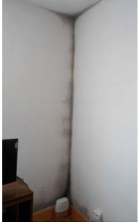
Moisissures et mauvaise ventilation, ASDER, 2015
