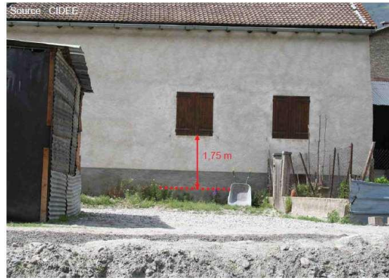
L'Arc à Termignon (l'eau est montée jusqu'à 1.75 m sous la fenêtre)
