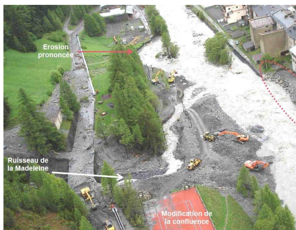
Apport en matériaux du torrent de la Madeleine à Lanslebourg
