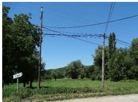
Réseaux aériens en surnombre
