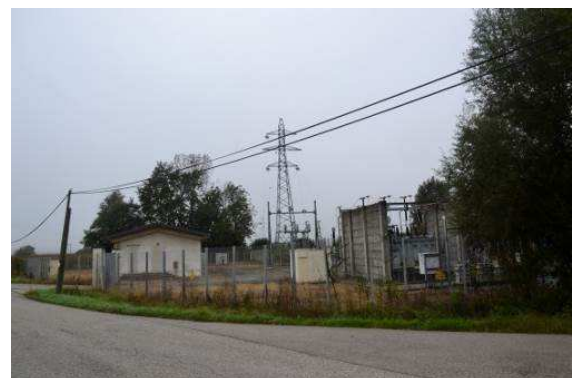
transformateur au nord des Bernards à Yenne
