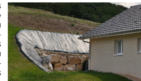
MOUVEMENTS DE TERRAIN ET ENROCHEMENT
