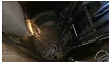
Photo ci-contre : intérieur du poste de relevage
