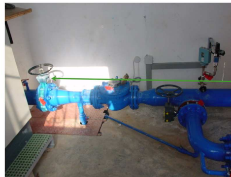
Départ vers le réservoir du Grand Mont
