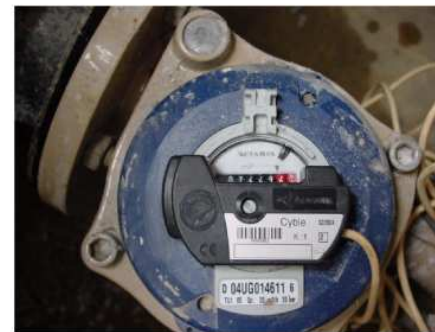
Compteur de distribution (Sous les Grangettes)
