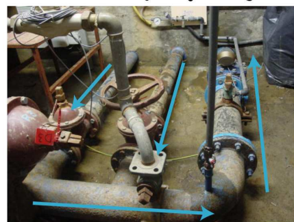
arrivée cuve 1 arrivée cuve 2 Distribution des Saisies
