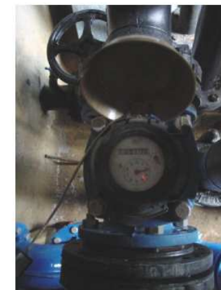
Compteur de distribution pour la neige artificielle
