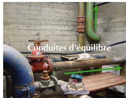
Adduction pompage Nantailly
