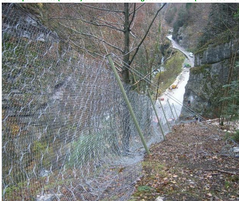
Ecrans pare-blocs avec poteaux peints (Gorges de la Bourne – 38)
