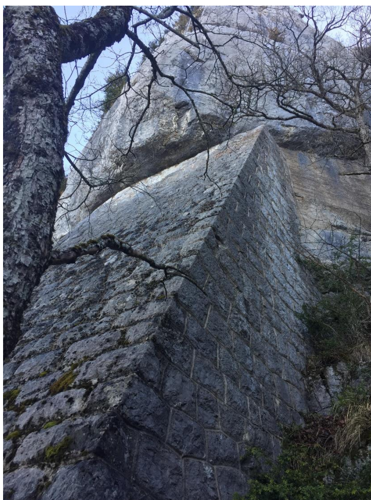
Le buton et le bloc conforté, vus depuis le sentier du pas de l’Echelle
