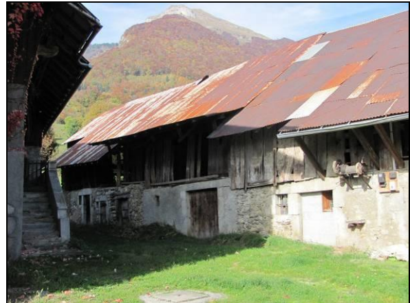
Photo 44 : Bâtiment ancien nécessitant travaux pour mise en valeur
