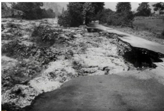
L’Arc en crue au niveau de la RN6 vers Pontamafrey (juin 1957)
