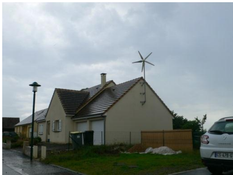
Initiative privée d'installation d'éolienne
