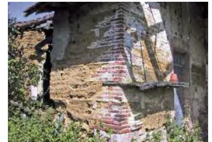
Une construction en ruine irrécupérable
