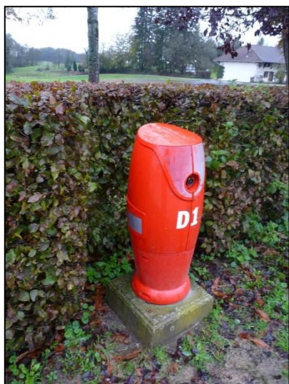
Borne à incendie
