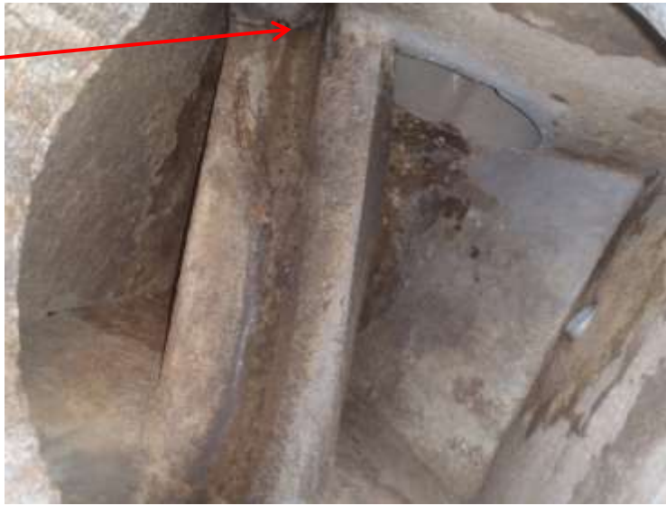
Déversoir à supprimer (n°862, Place du Petit Marché)
