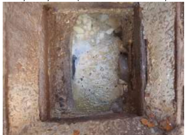
Bouchon et mise en charge (n°965 - Rue 3 Carreaux)
