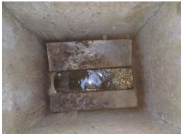
Grosse infiltration radier (n°263, Rue J. Guéritaine)
