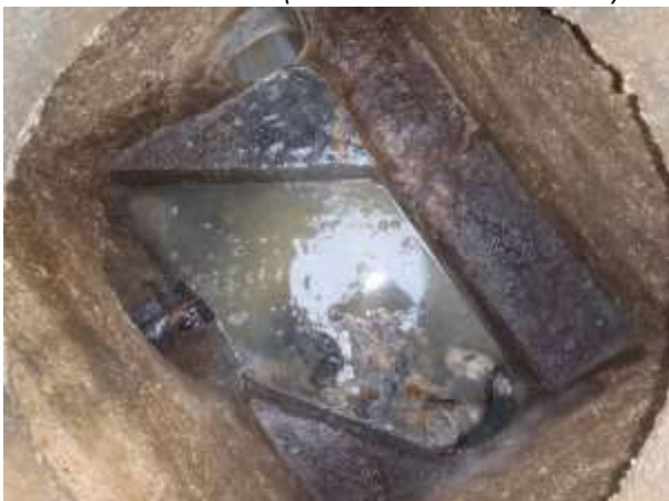
Obstruction (n°579 – Rue des Ravattes)
