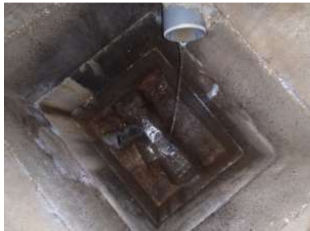
Infiltrations sur couronne (n°681, Chemin trépassés)
