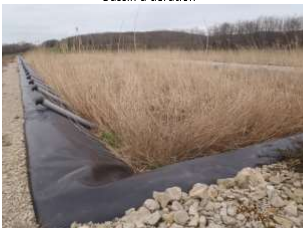
Lits plantés de roseaux pour traitement des boues
