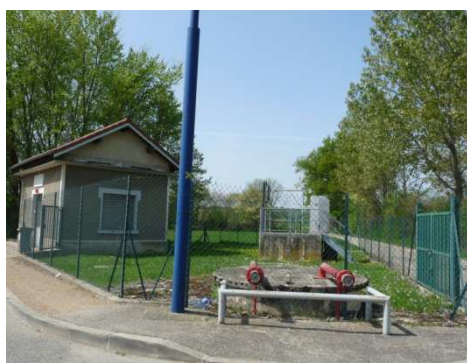
Station de relèvement / refoulement des Brosses
