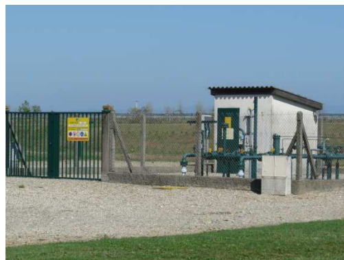
Station de gaz de l'aéroport de Saint-Exupéry
