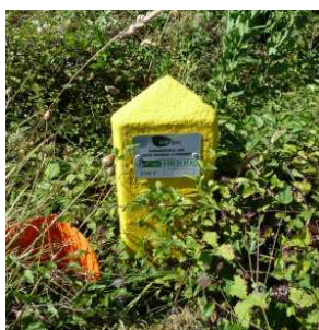
Borne de canalisation de gaz
