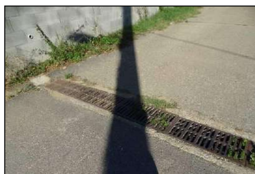
Caniveau de récupération des eaux pluviales en bas du chemin de Cussinette
