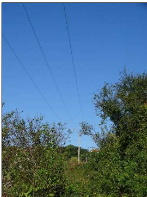
Ligne électrique traversant le site
