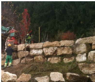
Enrochement de type cyclopéen interdit
