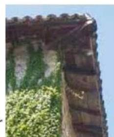
Forget débordant ancien, sans gouttière
