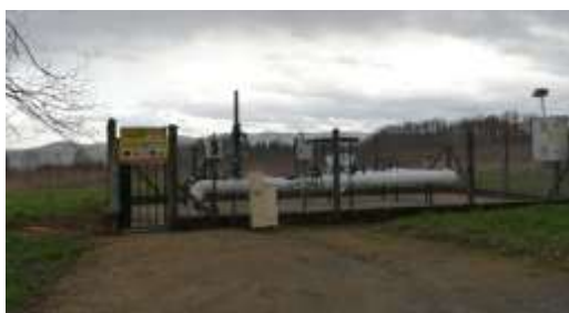
Poste de Gaz de Saint Germain
