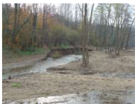
Effondrement des berges de la Brévenne
