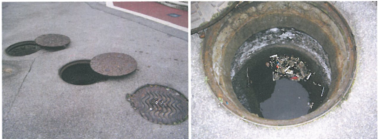
Figure 3-3 : Poste du quai d'Herbouville (dysfonctionnement)
