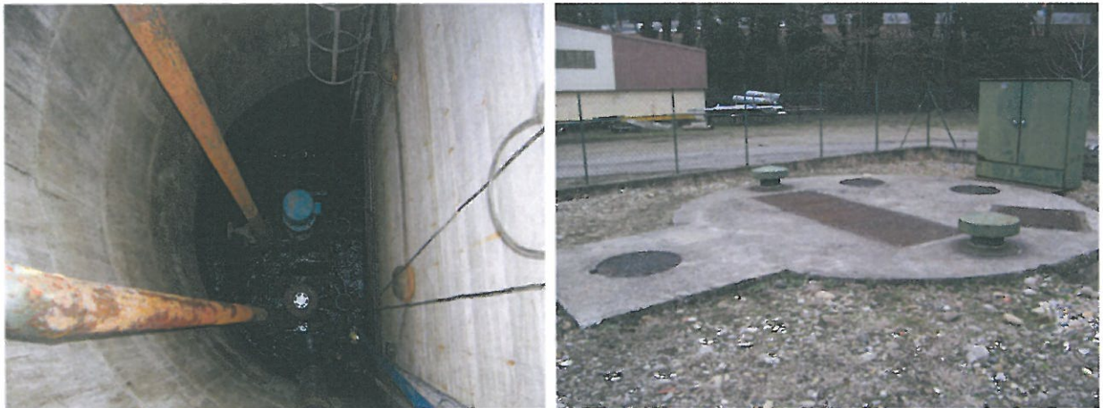
Figure 3-2 : Poste de Vézérance (trace d'infiltration, armoire électrique)
