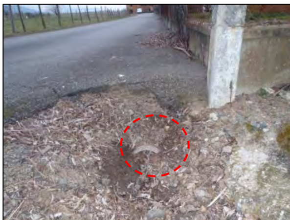
Buse Ø300 obstruée – Chemin des Places
