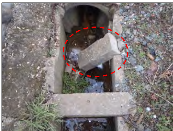
Buse cassée – Route de Saint-Romain
