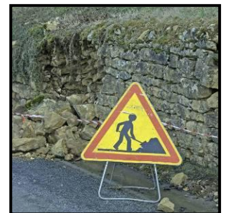
283 – mur en ruine
