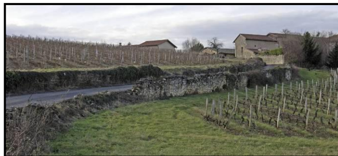
203 – usure du mur en continuité du bâti de Gros Bois
