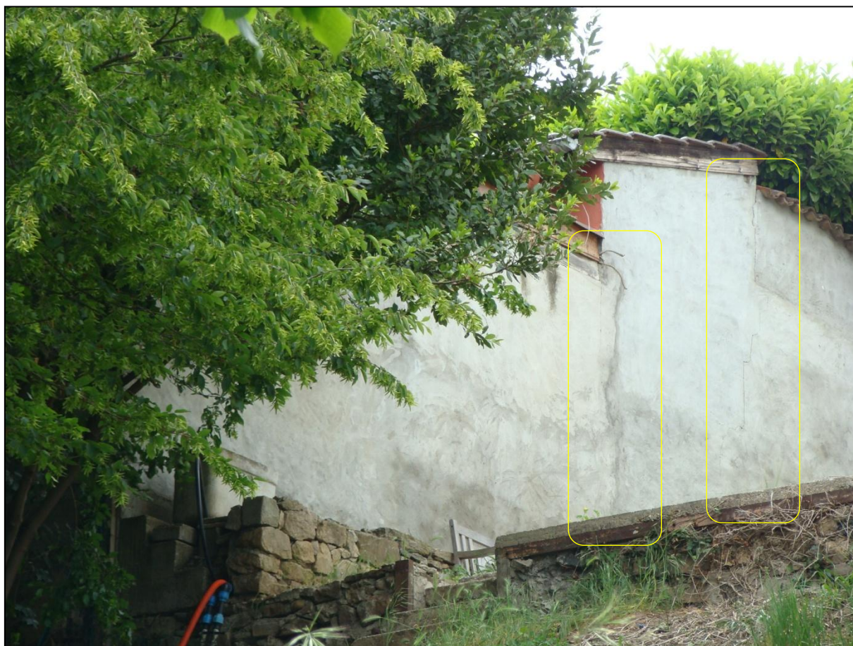
Figure 18 : Fissuration du mur mitoyen suite au mouvement des terrains vers l'aval [Source : IMS RN ]
