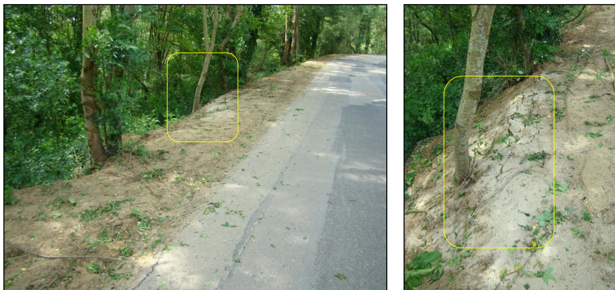
Figure 20 : Fissuration du remblai de la route de la Durantière [Source : IMS RN ]
