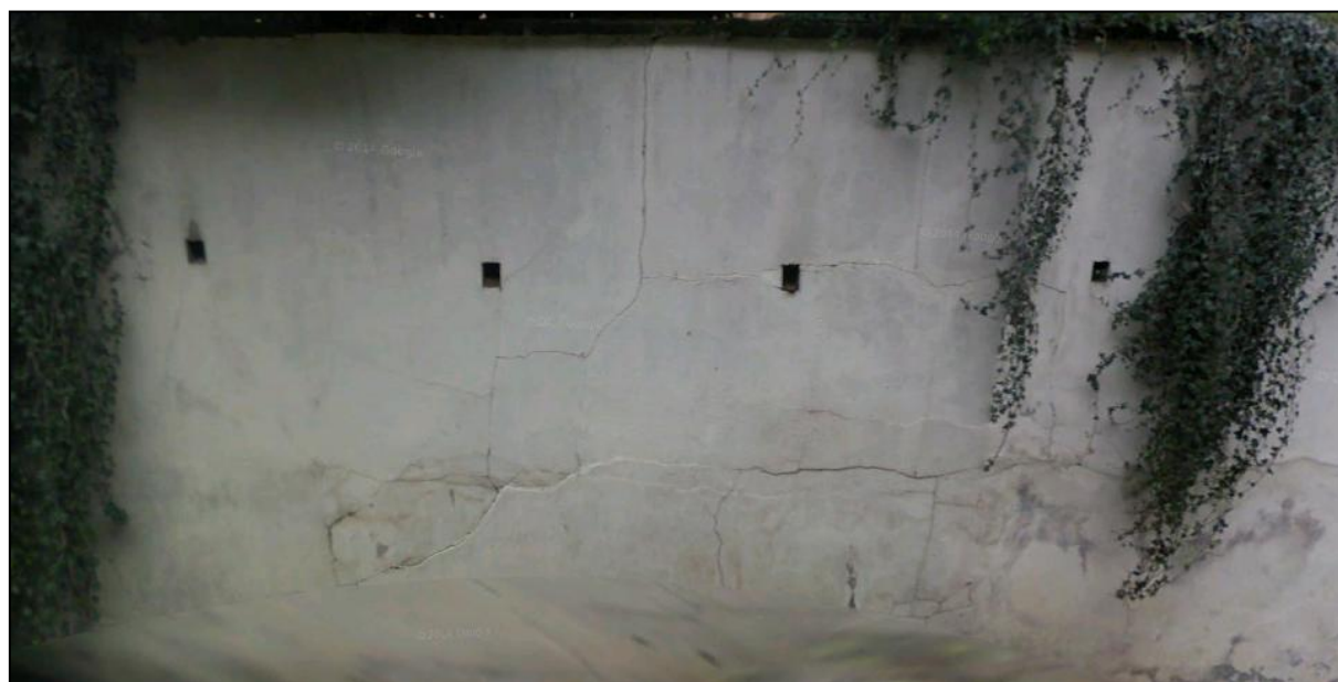
Figure 21 : Mur de soutènement endommagé le long de la route de la Durantière, à l'Est du Mont [Source : Google Earth]
