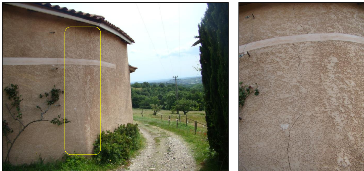
Figure 24 : Fissuration d'un bâtiment en bordure de versant au Taravel (et présence d'un confortement pour limiter l'évolution du phénomène) [Source : IMS RN ]
