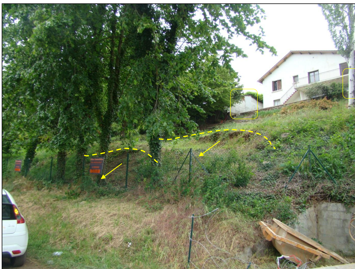
Figure 17 : Déformations dans le versant en amont de la route de la Durantière et localisation des désordres constatés sur les constructions (rectangle jaunes) [Source : IMS RN ]
