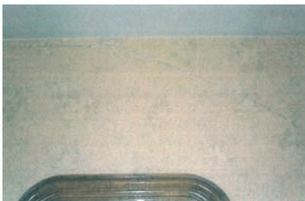
Fissuration intérieure, tapisserie déchirée - Maison André.
