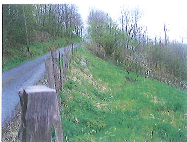
V47 - Z6 - Glissement chemin (W)
