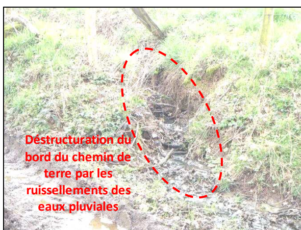
Photo 3 : Erosion des bords du chemin de terre en direction du Chemin de Lajay
