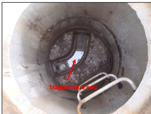
Dépôts – Regard n°31 – Lotissement des Sources
