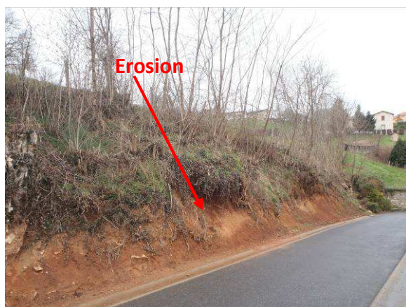
Erosion du talus au droit du chemin des Vignes
