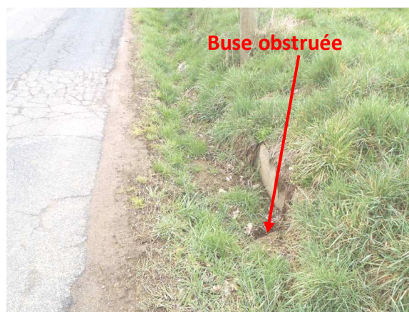
Buse obstruée au droit du hameau « Le Cougny »
