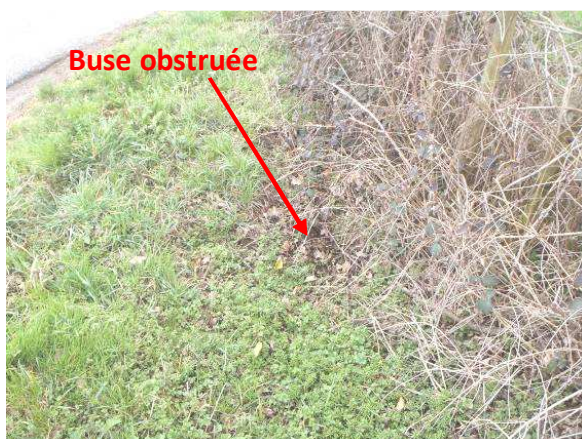
Buse obstruée au droit du hameau « Le Haut du Séchat »
