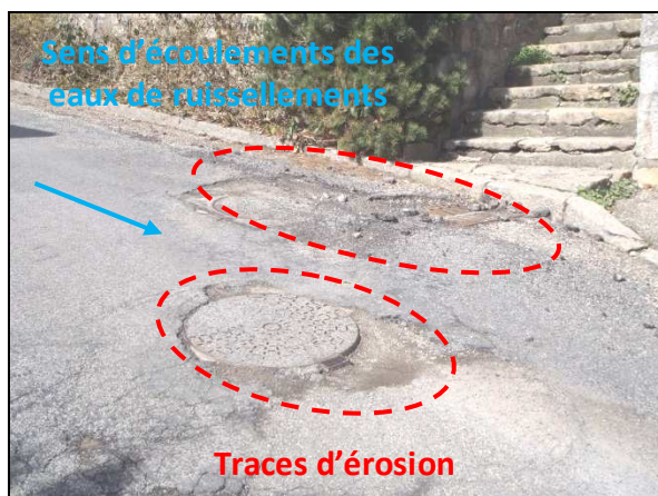
Trace d'érosion au droit de l'Eglise
