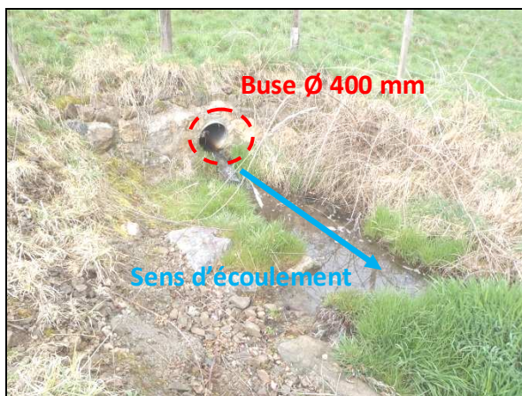
Exutoire final des bassins de rétention BR1 et BR2 - Buse Ø 400 mm
