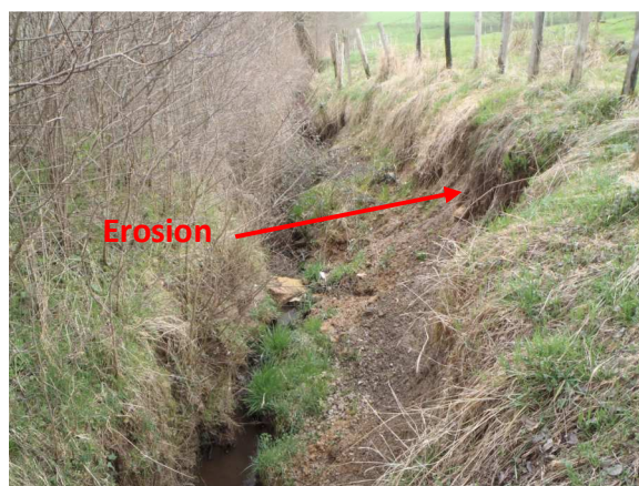
Erosion du fossé au droit de la scierie du bourg communal
