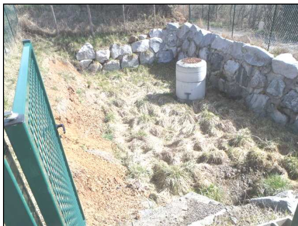
Vue générale du bassin de rétention à ciel ouvert au droit du lotissement « Clos des Roches »
