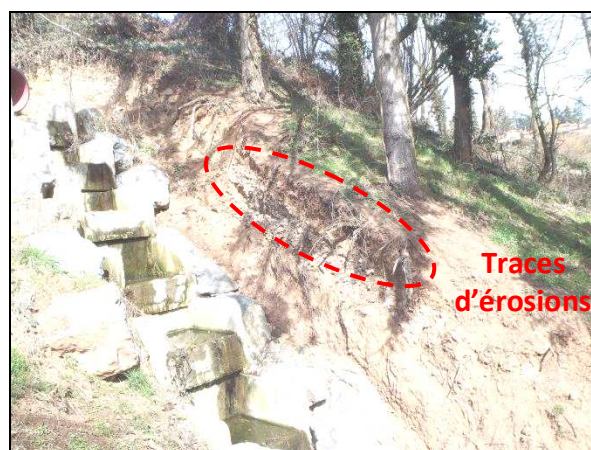
Trace d'érosion le long de la descente des eaux pluviales en sortie du Ø 600 mm
