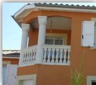
Type de balustres interdites
