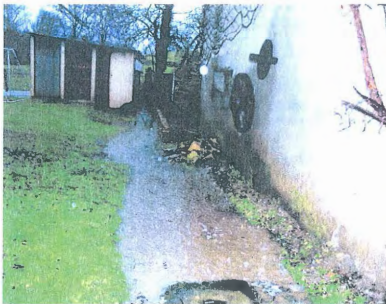
MUR D'UNE DES MAISONS INONDEE
