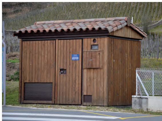
Exemple de transformateur électrique intégré à son environnement
