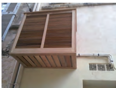
Exemple de dissimulation d'une pompe à chaleur à défaut d'être intégré à la façade
