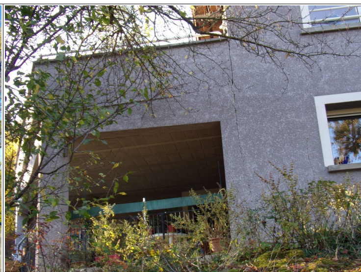
Figure III 6: maison fissurée dans le hameau de Saint-Paul.
