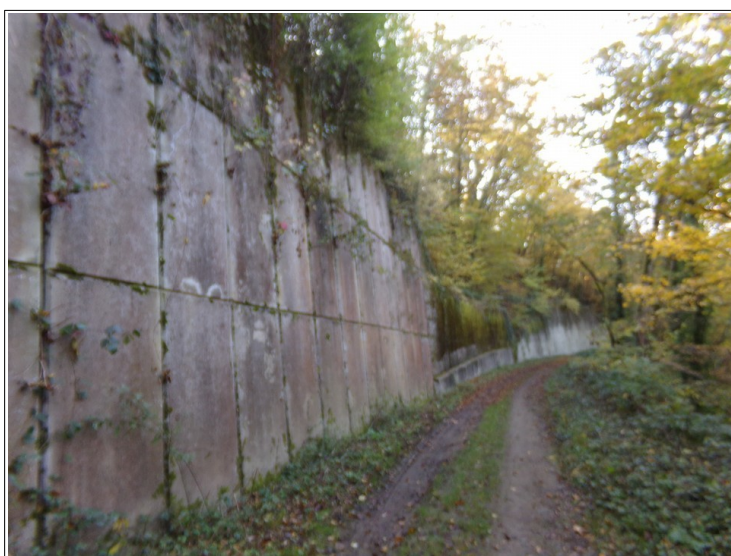
Figure III 7: mur de soutènement le long de la voie du Tacot, au droit du hameau de Billy. Cet ouvrage conforte également la RD338 située à l'amont.
