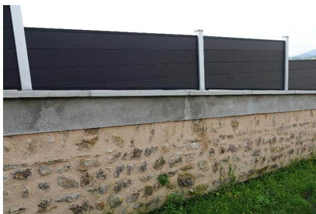
Type de traitement de murs non autorisés
