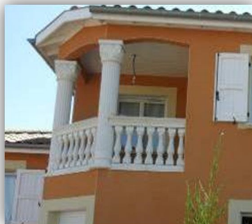
Type de balustres interdites
