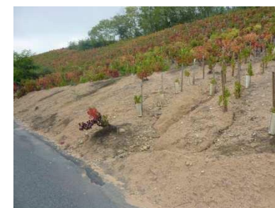
Versant ensablé Ruissellement important
