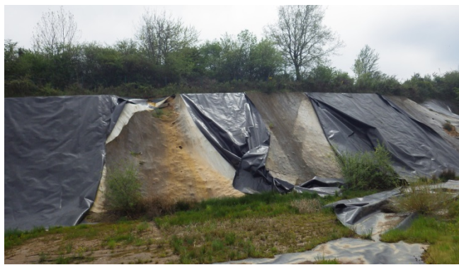
Géomembranes et géotextiles arrachés sur le talus Nord (environ 8mde haut, dont seulement 2m utiles cf talus aval de 2m de hauteur environ)
