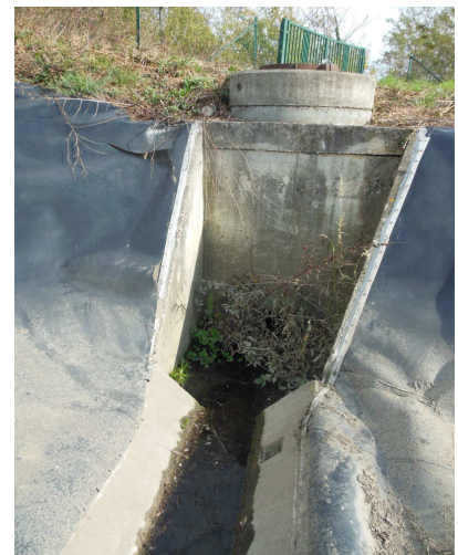
Regard avec limiteur de débit
