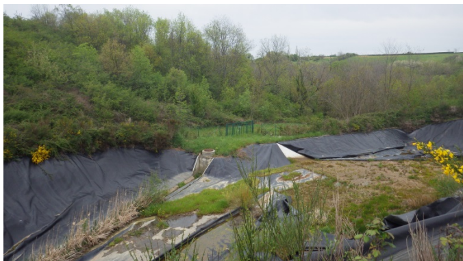
Vue depuis l'amont vers l'exutoire – bassin non entretenu
