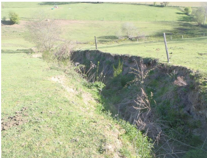
Erosion d'un fossé à l'exutoire d'un déversoir d'orage – Commune de Saint-Martin-en-Haut (SMH17)
