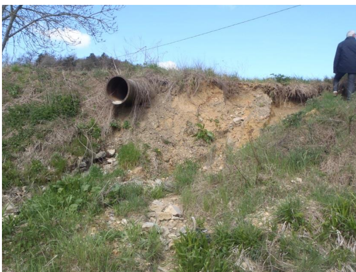
Erosion de digue de plan d'eau – Commune de Saint-Martin-en-Haut (SMH20)
