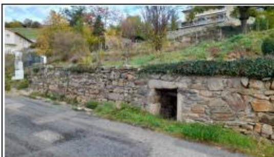
Puits intégré mur soutènement au départ chemin du bois de Pinloup sous C0686
