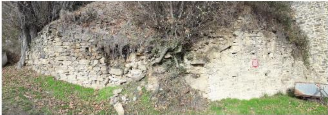
Mur de soutènement d'une propriété privée, belle construction dégradée par les racines d'un arbre parcelle D0486 (coté sortie du hameau de l'Adret Ouest)
