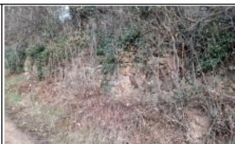
Soutènement en fin de zone habitée chemin du bois de Pinloup sous C0281(bien dégradé)
