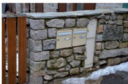
Exemple d'intégration d'éléments techniques
