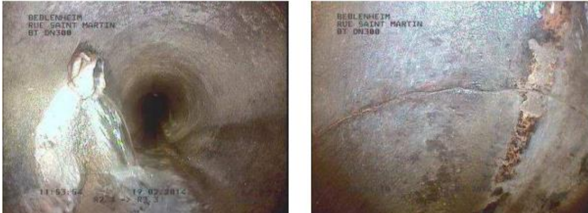
Figure 56 : Défauts Rue Saint-Martin - IRH Ingénieur conseil
