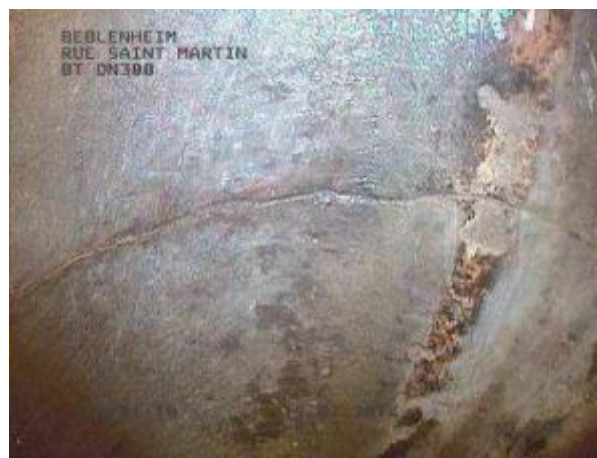
Figure 58 : Fissures circulaires du collecteur béton Rue des Vosges - IRH Ingénieur conseil
