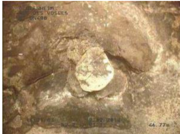
Figure 57 : Effondrement partiel de la voûte du collecteur béton Rue des Vosges – IRH Ingénieur conseil
