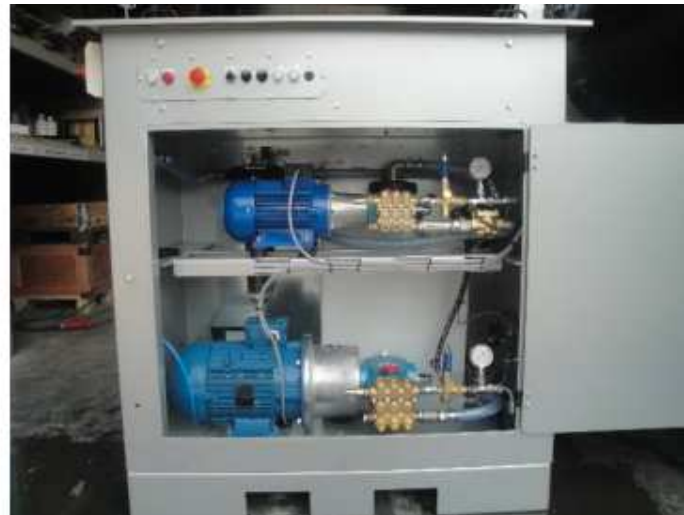
Pompe et système de filtration/désinfection
