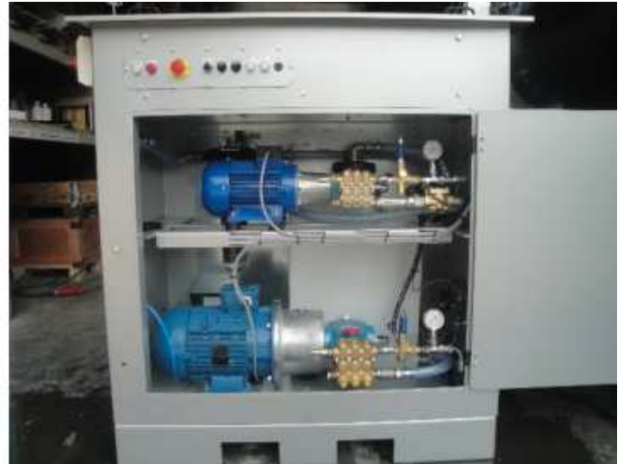
Pompe et système de filtration/désinfection
