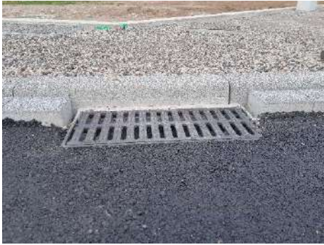
Figure 4: Exemple d'avaloir non sécurisé : les amphibiens parvenus sur la chaussée longent le rebord du trottoir et chutent dans le regard.
