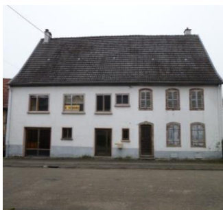
Percement des ouvertures sur la partie grange dégrade l'identité du bâti traditionnel
