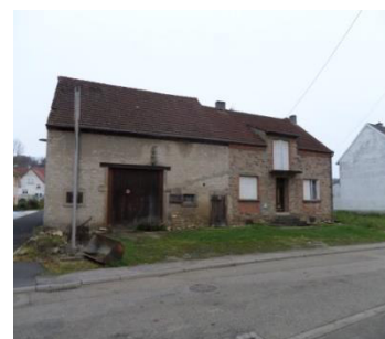
Modification des ouvertures et ajout de balcon dégrade le bâti ancien
