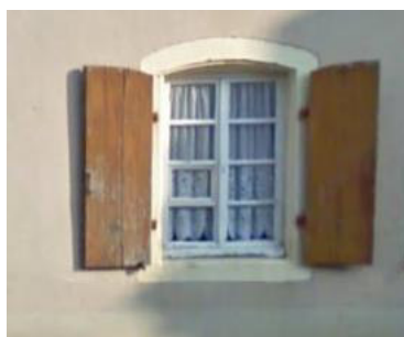
Fenêtre en bois, subdivisée en 8 carreaux, volet plein, encadrement en pierre taillé, linteau en forme d'arc centré
