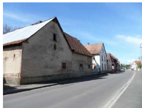
Rue de Colmar, dépendance en mauvais état
