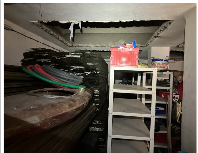
Photographie 18 : RDC – Sous les 6 silos à orge
