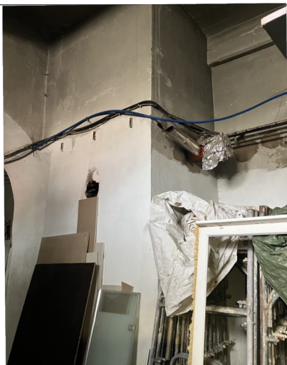
Photographie 23 : RDC – Pièce de 250 m 2 contenant La cheminée de la chaudière
