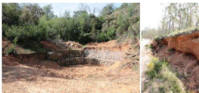
Zone d'érosion et ouvrage de protection.
