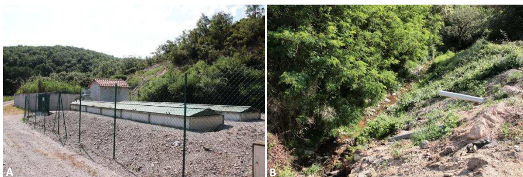
Station d'épuration de Llauro (A) et milieu récepteur (B).
