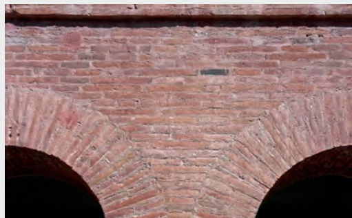
Arc plein d'ouverture
