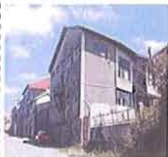
Bâti dégradé en centre et espaces vacants
