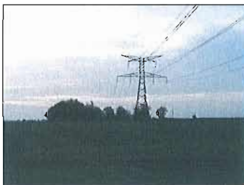
Lignes électriques Haute Tension et bosquet dans une vaste plaine agricole
