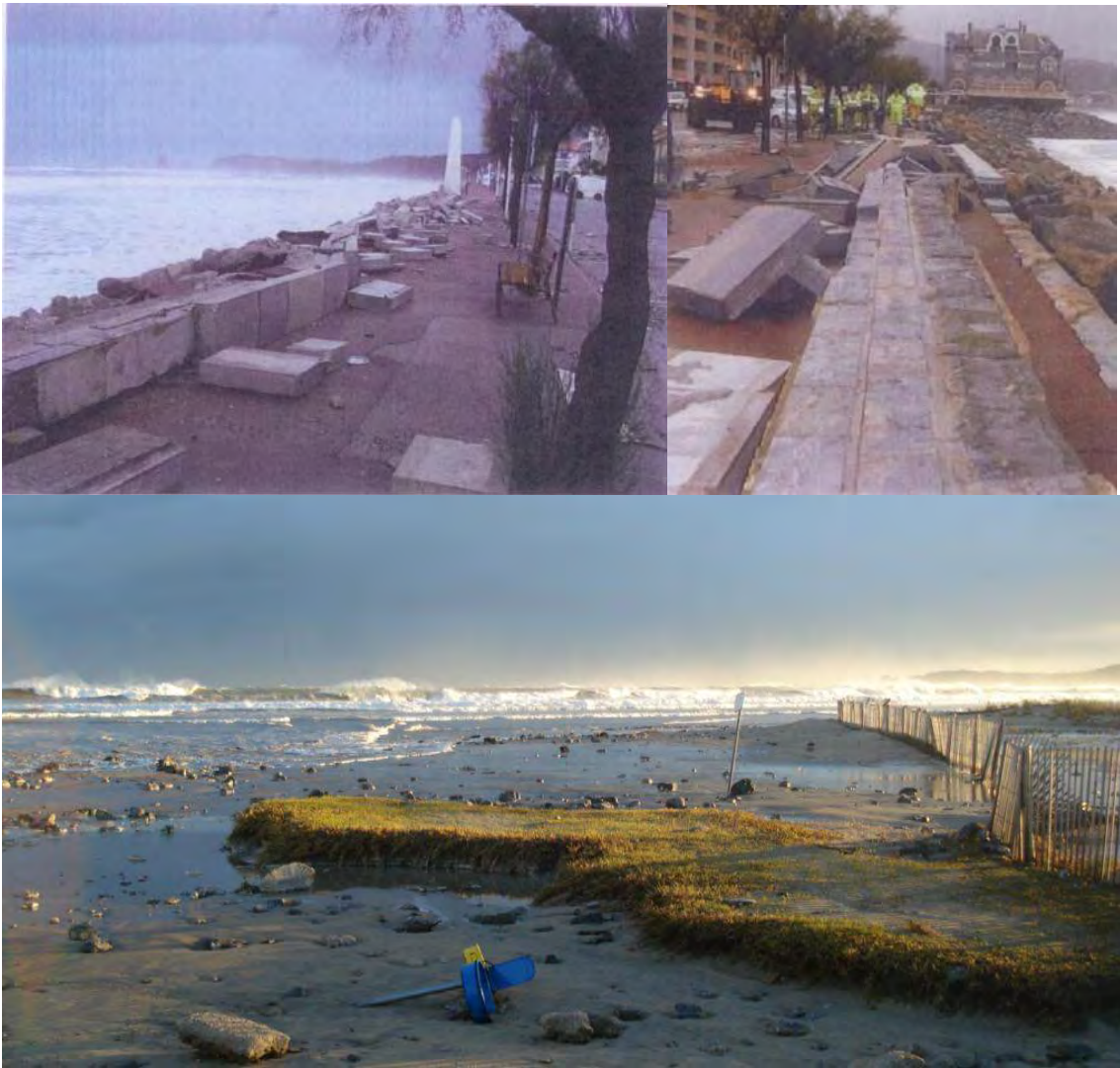
Figure 24 : Dégâts occasionnés sur le perré et érosion de l'herbier de la plage d'Hendaye, durant la tempête du 9 novembre 2010.
