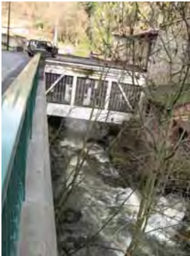
Photo 11 (point 4) : usine en zone inondable dans le secteur de gorges (amont de Thiers) (source BCEOM)
