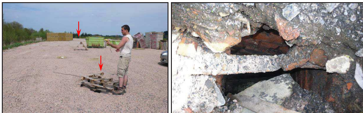
Deux petits effondrements localisés sur des galeries techniques mal comblées du carreau du puits La Bouble n° 5
